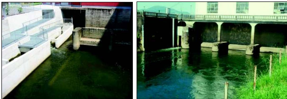
Abbildung 26 und Abbildung 27: Optimale Anordnung eines FAH Einstieges an einem Wehr mit Turbine, am Ufer auf der Höhe des Wehres mit deutlich zu erkennendem Lockstromimpuls im Bereich des FAH Einstieges, die sich deutlich von der Umgebungsströmung abhebt (DUMONT et al. 2005).
